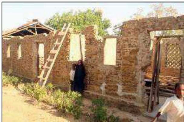
強風で屋根が吹き飛ばされた教室
