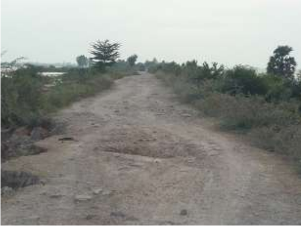
穴があいている道路
