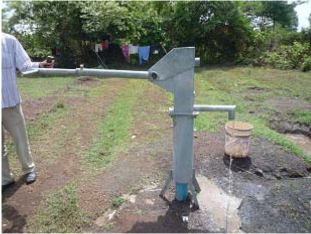
ポンプ井戸（地下 26m：校舎建設の手前に設置）
