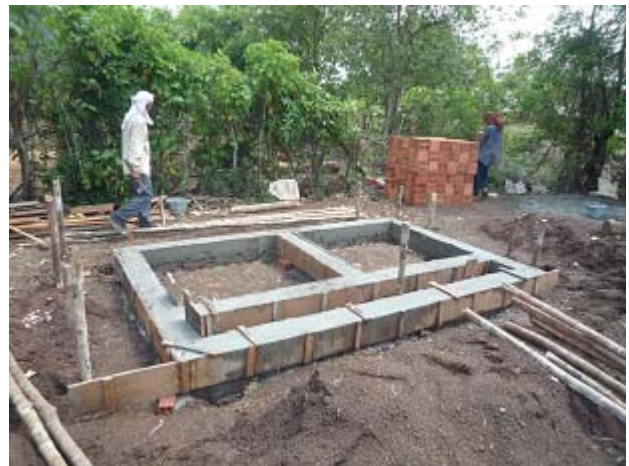
トイレ設置場所
