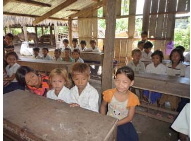
左側には壁がない
