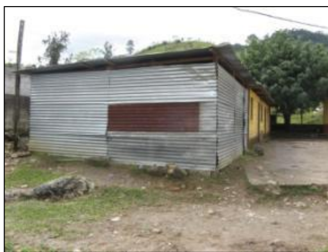
劣化が著しく、授業を実施するのが難しい状態の教室
